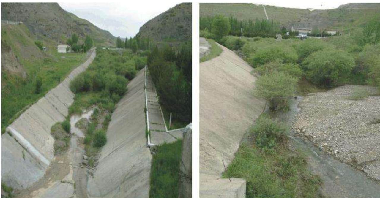
2-расм. Келтиргич канал.(Канал қиялиги ўпирилиши).
