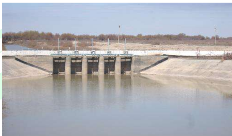
Рис.1 - Регулирующее сооружение на оросительном канале
